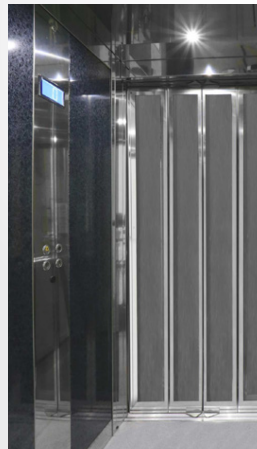
Soffietto in Cabina
